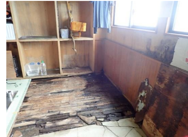
腐食した1階床
