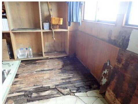
腐食した1階床
