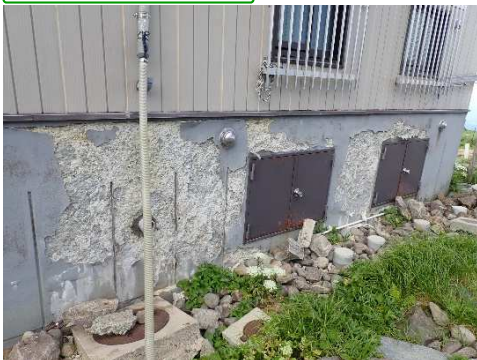
剥離した外壁部
