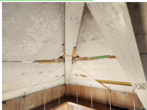
腐食した天井
