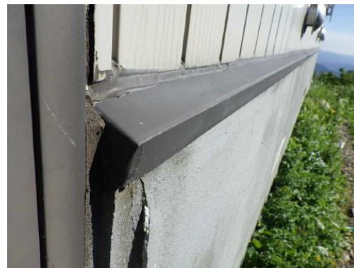
破損した水切り
