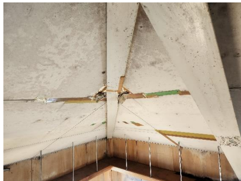
腐食した天井
